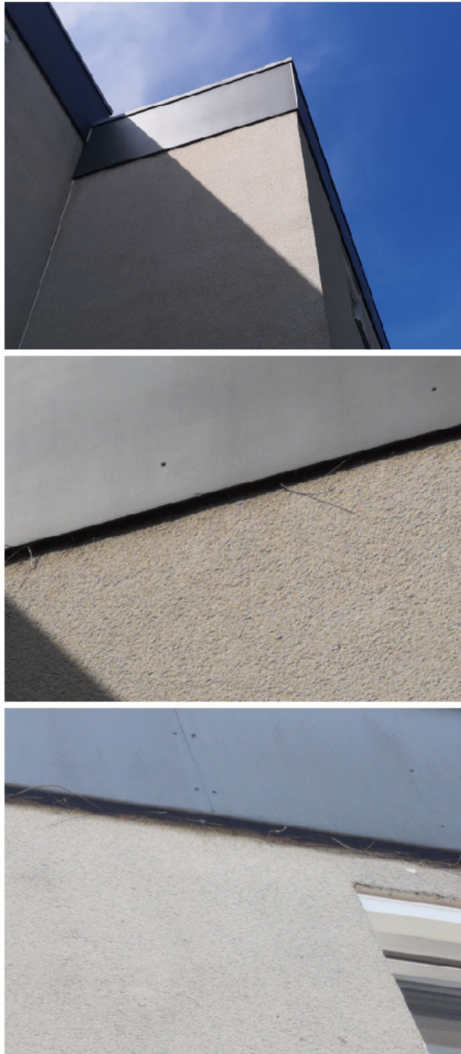
Abb. 8: Blick auf Attikaverkleidung von Neubergstrasse 50b aus dem Innenhof am 27.05.2025. Überreste von altem Fassadenbewuchs zu erkennen. (Quelle: Nadja Stingl-Sinn)
