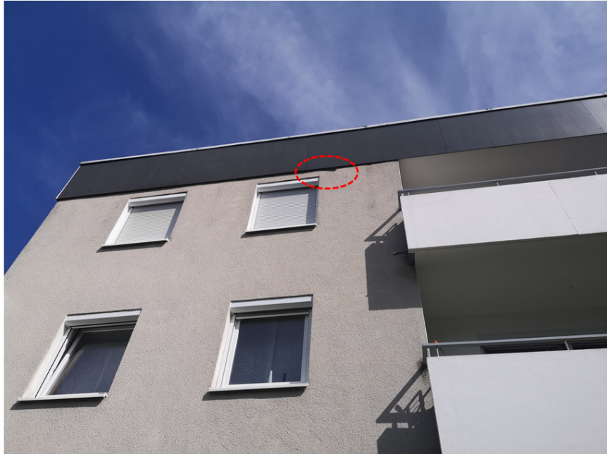
Abb. 9: Blick auf Attikaverkleidung von Neubergstrasse 50d auf Seite der Grünfläche/Sandkasten am 27.05.2025. Gelöster Gitterschutz von Attikaelement zu erkennen. (Quelle: Nadja Stingl-Sinn)
