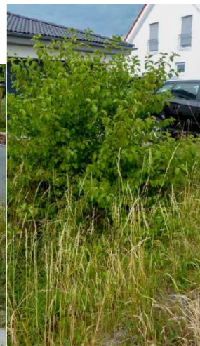
Bild 11: Unerwünschter Gehölzaufwuchs im Bereich des Überlaufes - hier ist Pflege angesagt.
