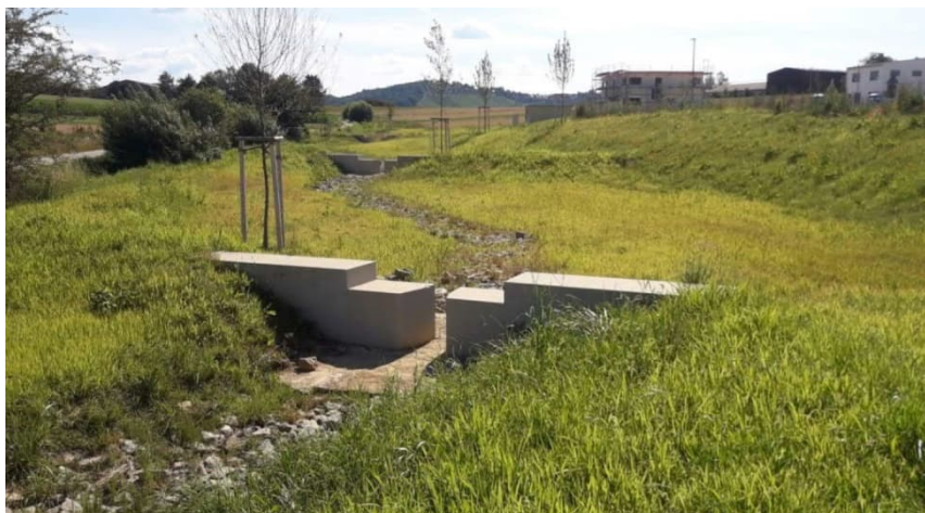
Abbildung 44: Drosselemente aus Betonfertigteilen (BV Winnenden „Adelsbach“, HL)
