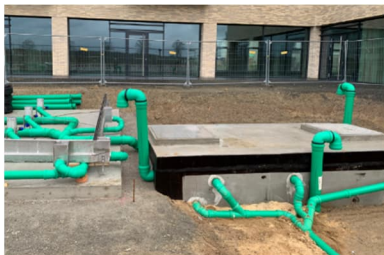
Abbildung 19: Unterirdische Beton-Zisterne mit Zu- und Abläufen (HL)
