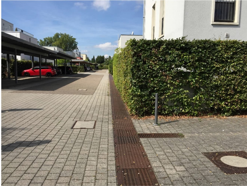
Abbildung 29: Öffentliche Kastenrinne (abgedeckt) für Grundstücks- und Straßenentwässerung (Scharnh.Park, HL)
