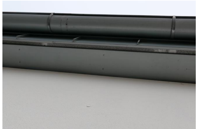
Abbildung 9: Spalten im Traufbereich werden aufgrund der geringen Tiefe und der Aluminiumverkleidung als suboptimale Quartierstruktur bewertet.
