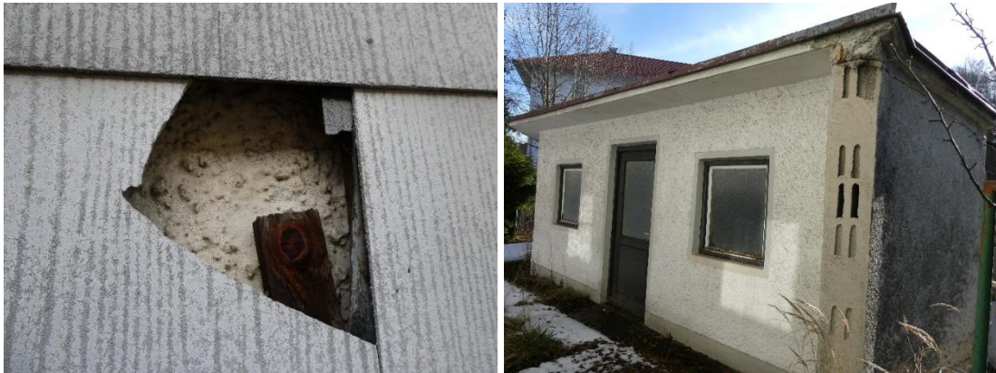
Abb. 12: Beschädigte Fassade mit dahinterliegendem Hohlraum (links), Garage mit vereinzelt Nischen (rechts)
