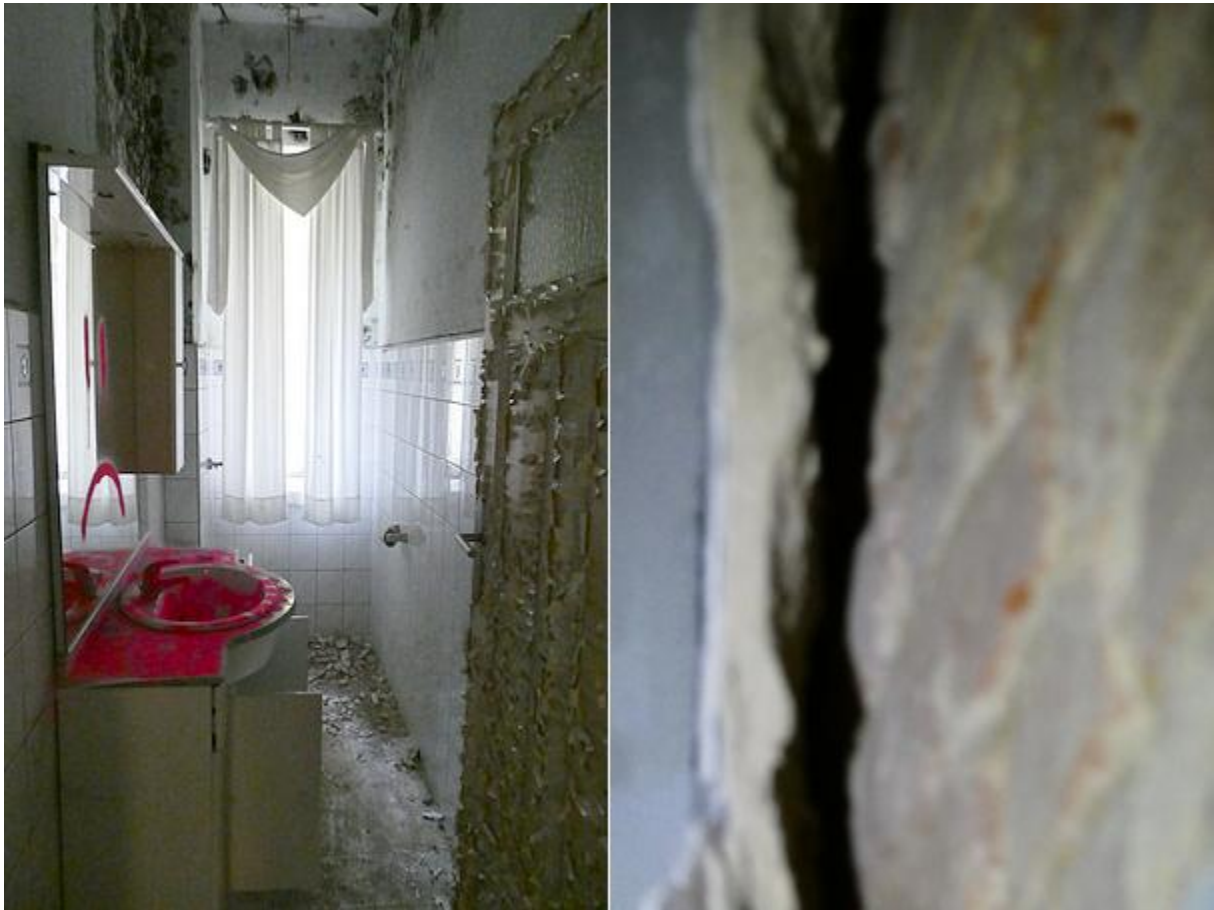
Abbildung 45: Feuchtraum im EG mit Zustand der Wand
