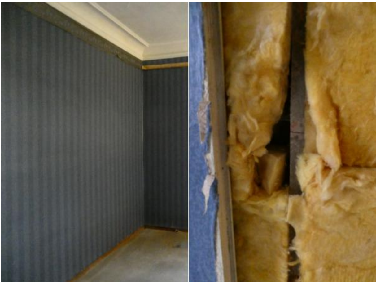
Abbildung 52: Schlafzimmer mit Wandbeschädigungen
