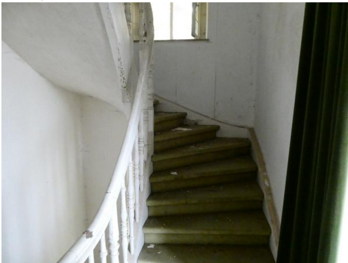
Abbildung 54: Treppe zum 2. OG; Zustand nicht abschätzbar.
