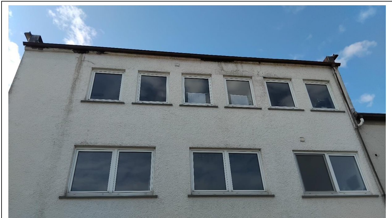
Quartierpotential Schadstellen im Traufbereich
