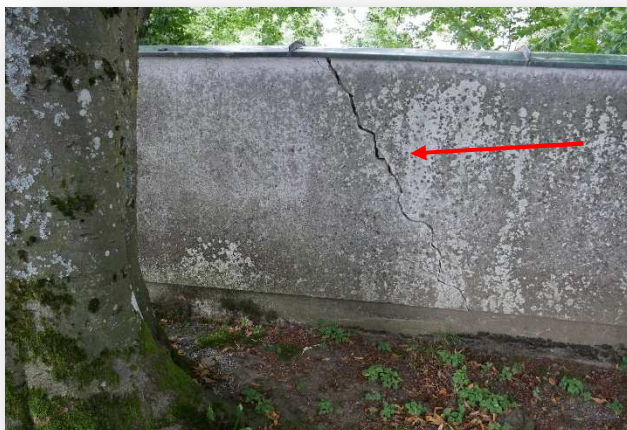
Abb. 8 Riss in der Grundstücksmauer
