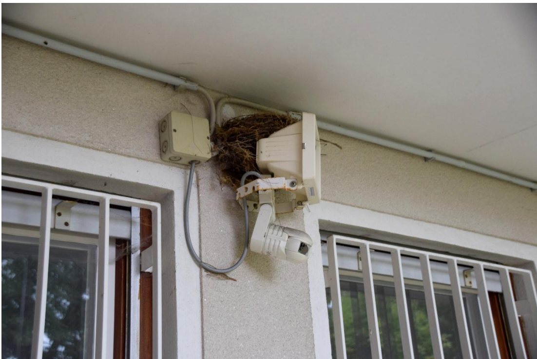
Abbildung 6: Vogelnest am Bestandsgebäude
