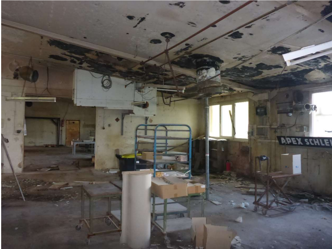
Abbildung 7: Gebäudeinneres der Fertigungshalle mit erkennbaren Schäden am Dach (Aufnahme vom 14.09.2023).
