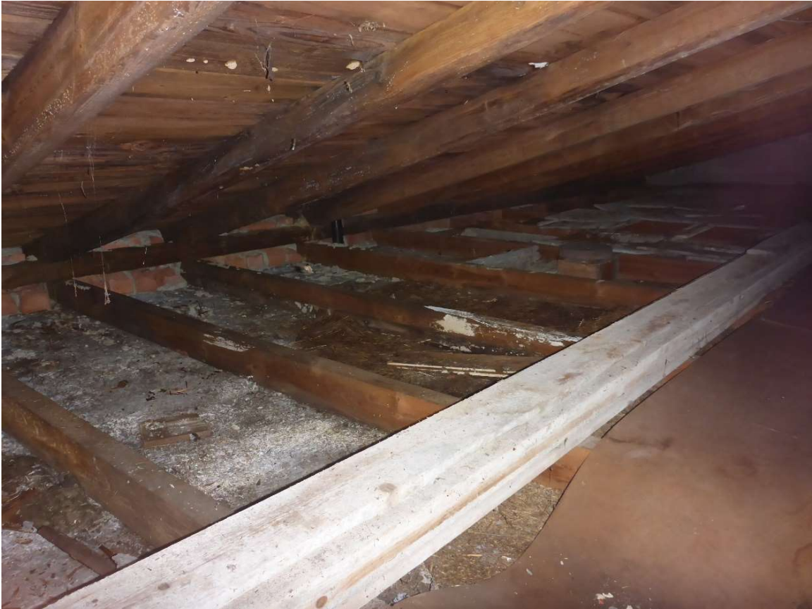
Abbildung 11: Dachbodenbereich des Gebäudeanbaus ohne Spuren von Fledermäusen oder Hinweise auf Nistplätze. Gut sind die Löcher in der Dachhaut erkennbar (Aufnahme vom 14.09.2023).
