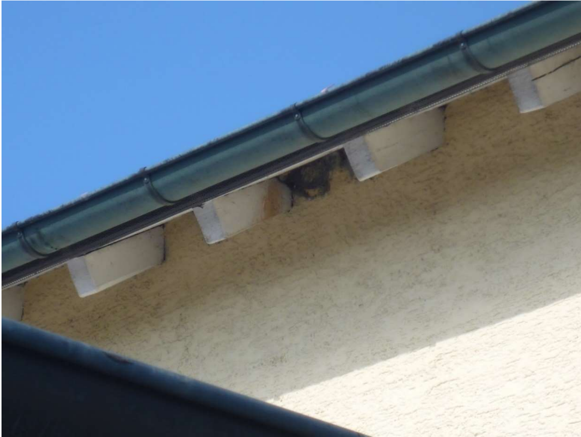
Abbildung 5: Putzfassade mit Überresten eines Schwalbennestes unter der Traufe auf der Südseite des Bürogebäudes (Aufnahme von 14.09.2023).
