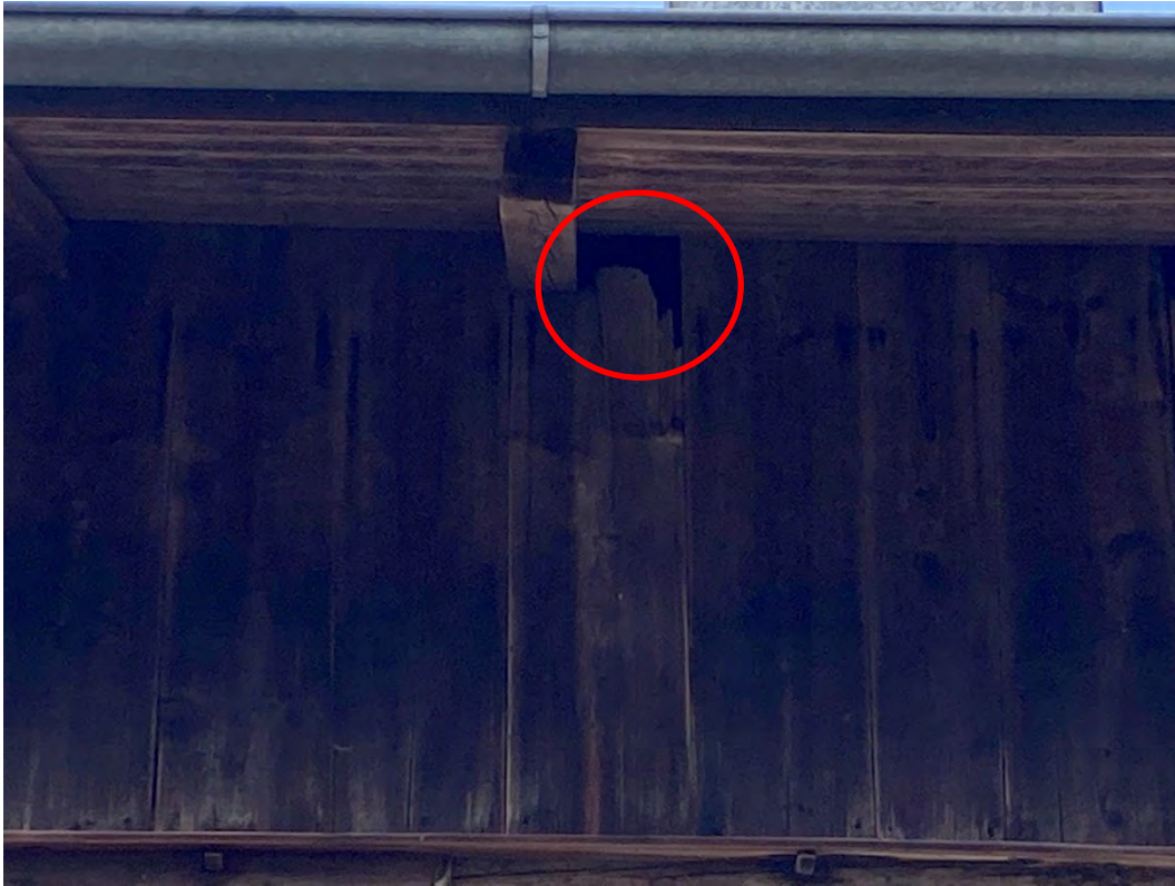
Abbildung 9: Einflugmöglichkeiten unter dem Dachüberstand des Stallgebäudes (roter Kreis).
