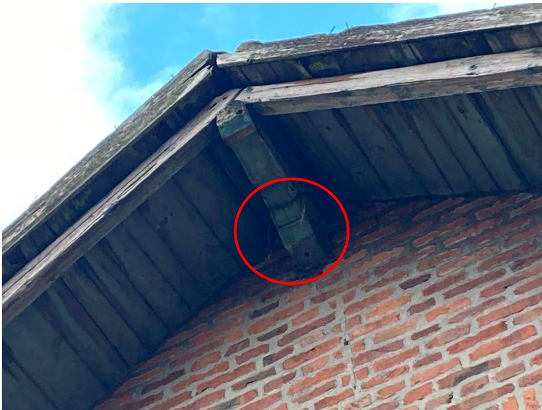
Abbildung 12: Nistmaterial an einem Balken an der Westfassade des Wohnhauses (roter Kreis).
