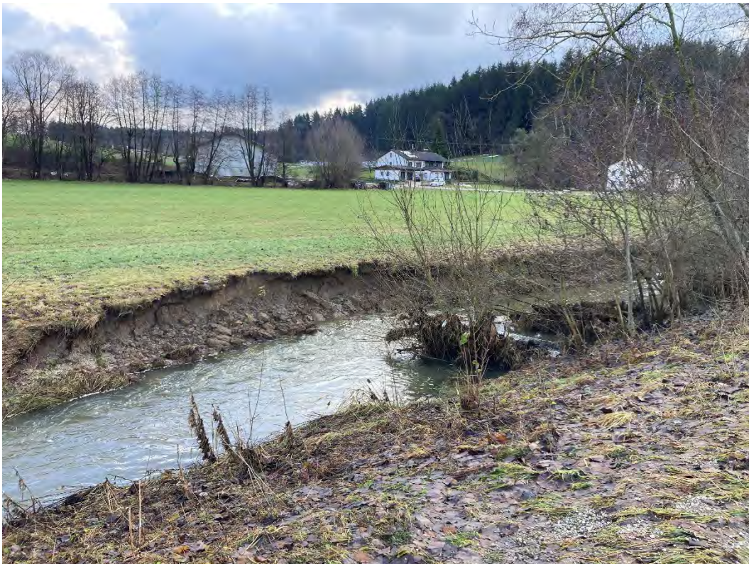
Abbildung 6: Uferabbruch an der Großen Vils.
