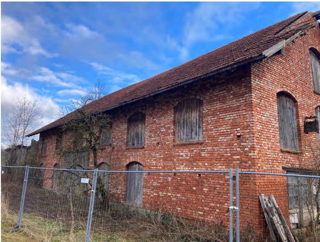
Abbildung 10: Ehemalige Scheune der Hofstelle im Plangebiet. Das Dach ist bereits am Einstürzen und bietet daher zahlreiche Einflugmöglichkeiten für Fledermäuse und gebäudebrütende Vogelarten. Blick von Südosten.
