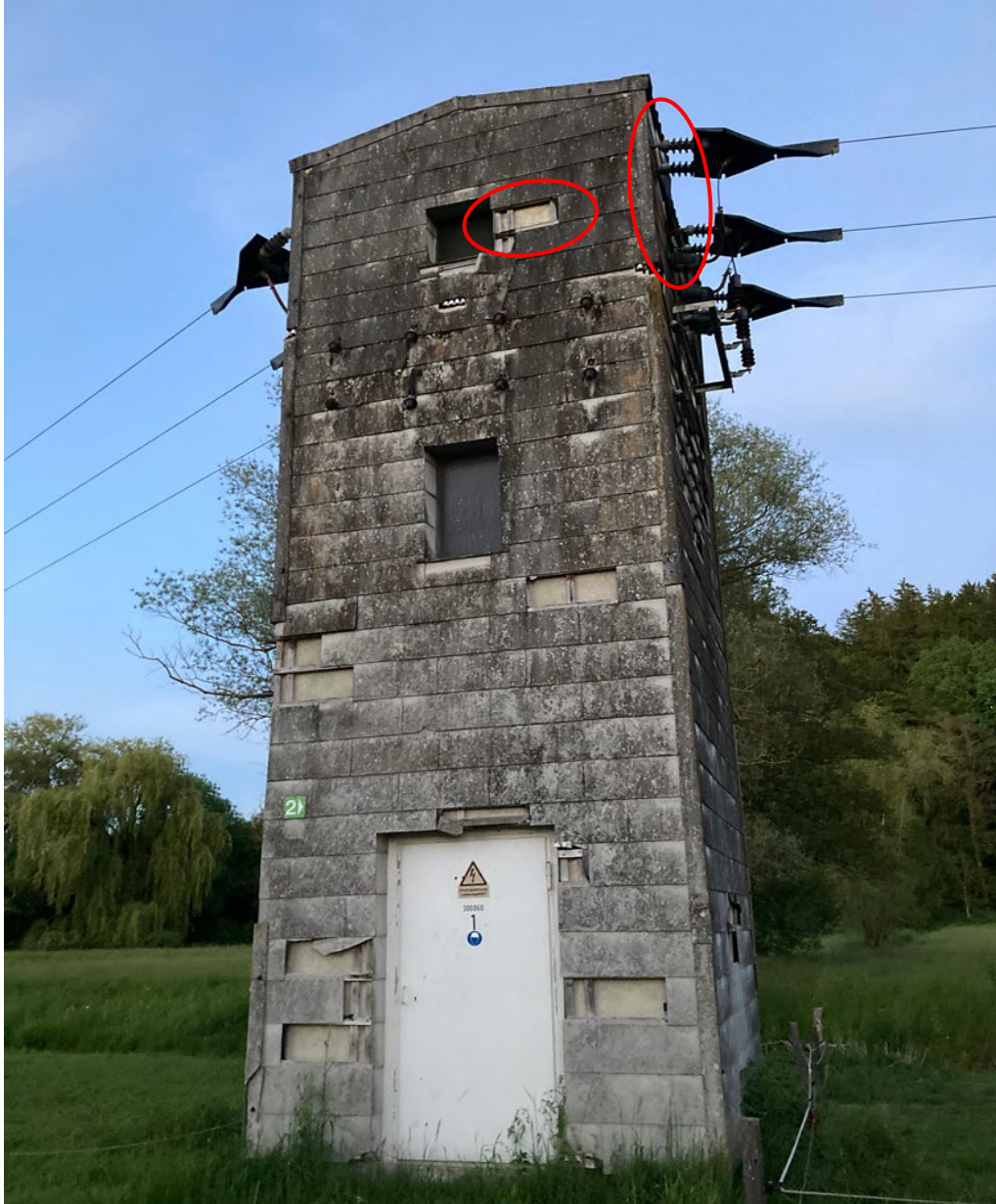
Abbildung 5: Trafohäuschen mit Fledermausquartier der Artgruppe "Mkm" hinter der Verkleidung. Die beobachteten Ausflüge fanden in den rot umrandeten Bereichen statt.
