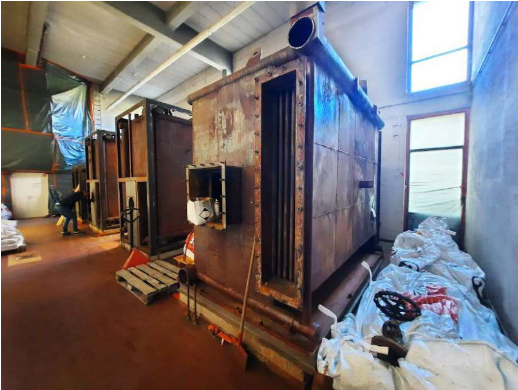
Abb. 20: KVF Nr. 07 – Stillgelegter Heizraum Blick nach Südwesten auf die stillgelegten Heizkessel Foto: Hydrodata GmbH, 29.10.2024
