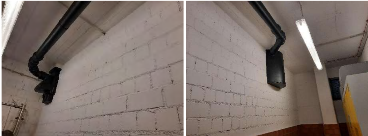
Abbildung 33: Ansicht der Abscheideranlage im Kellerraum K24. Foto: HYDRODATA GmbH, 29.10.2024
