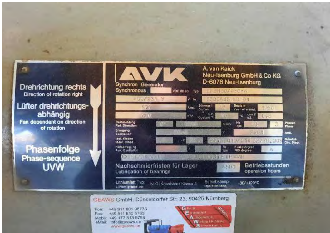
Abb. 31: KVF Nr. 08 – Notstromaggregat Typenschild des Aggregats. Foto: Hydrodata GmbH, 29.10.2024
