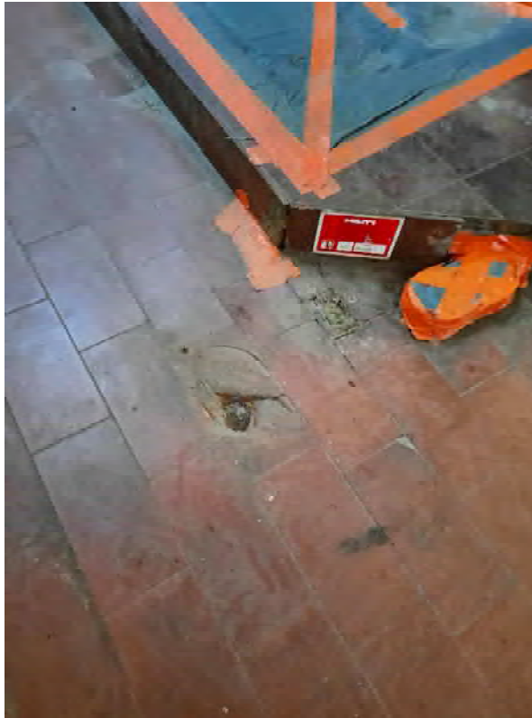
Abb. 22: KVF Nr. 07 – Stillgelegter Heizraum Bodenversiegelung im Bereich der Heizkessel. Foto: Hydrodata GmbH, 29.10.2024
