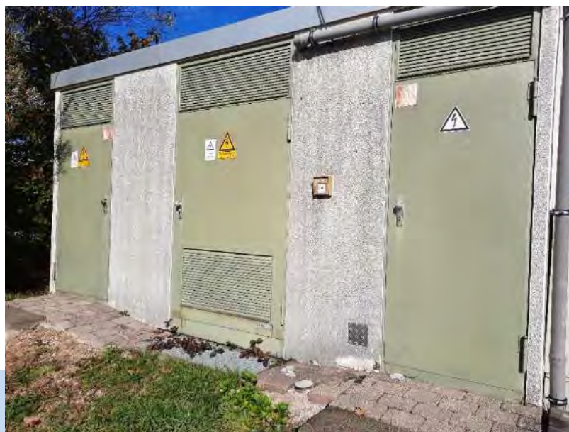
Abbildung 42: Außenansicht Trafo 158. Foto: HYDRODATA GmbH, 29.10.2024
