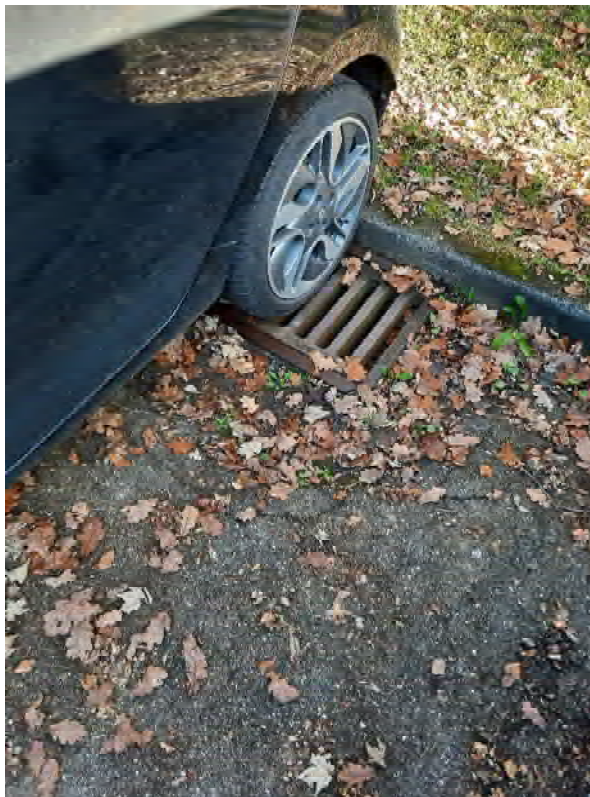
Abb. 86: KVF Nr. 27 – Parkplatz P177 Sickerkasten auf Parkplatz P177. Foto: Hydrodata GmbH, 29.10.2024
