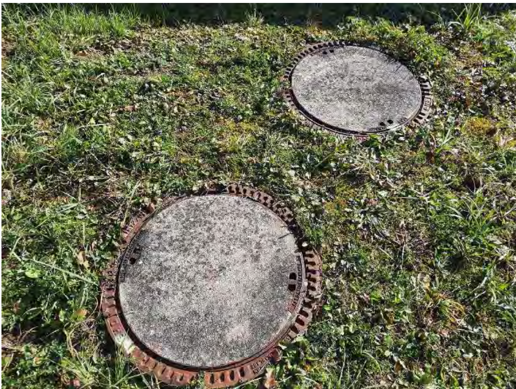
Abb. 56: KVF Nr. 17 – Abscheider bei Manipulationsfläche Abdeckungen des Koaleszenzabscheiders. Foto: Hydrodata GmbH, 29.10.2024
