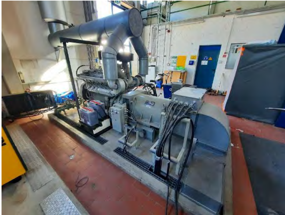
Abbildung 26: Notstromaggregat. Foto: HYDRODATA GmbH, 29.10.2024
