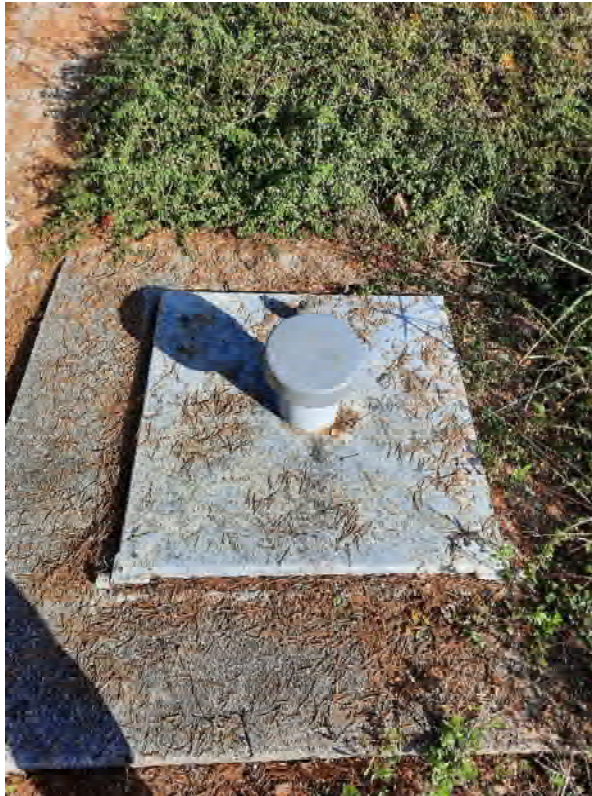
Abb. 38: KVF Nr. 09 – Öltanks Blick auf die Abdeckung von Tank III. Foto: Hydrodata GmbH, 29.10.2024
