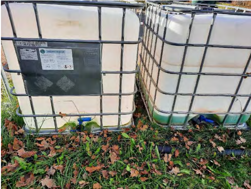
Abb. 83: KVF Nr. 26 – Notkühlung Detailaufnahme der beiden Kühlmittel tanks. Blick nach Westen. Foto: Hydrodata GmbH, 29.10.2024
