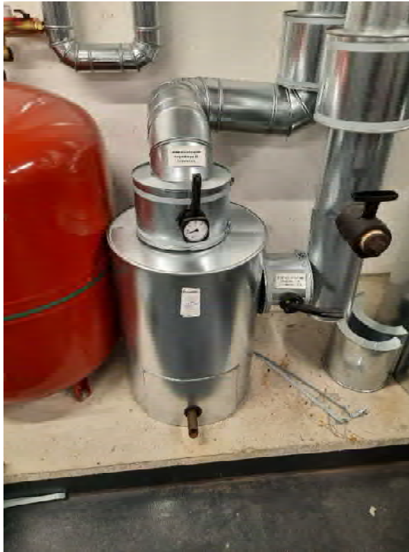
Abb. 17: KVF Nr. 05 – Heizraum Gebäude 109 Schlammfang des Heizkreislaufs. Foto: Hydrodata GmbH, 29.10.2024
