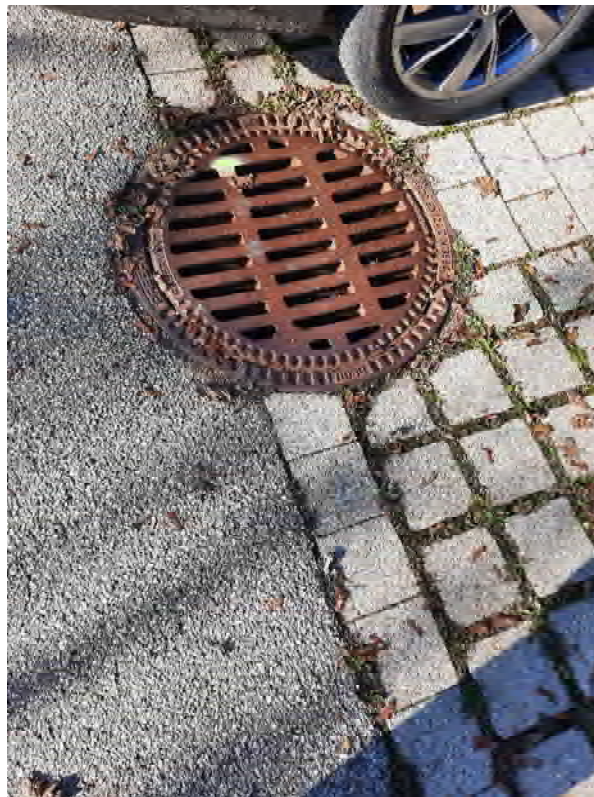
Abb. 65: KVF Nr. 20 – Parkplatz P172 Kanaldeckel im Bereich des Parkplatzes. Foto: Hydrodata GmbH, 29.10.2024
