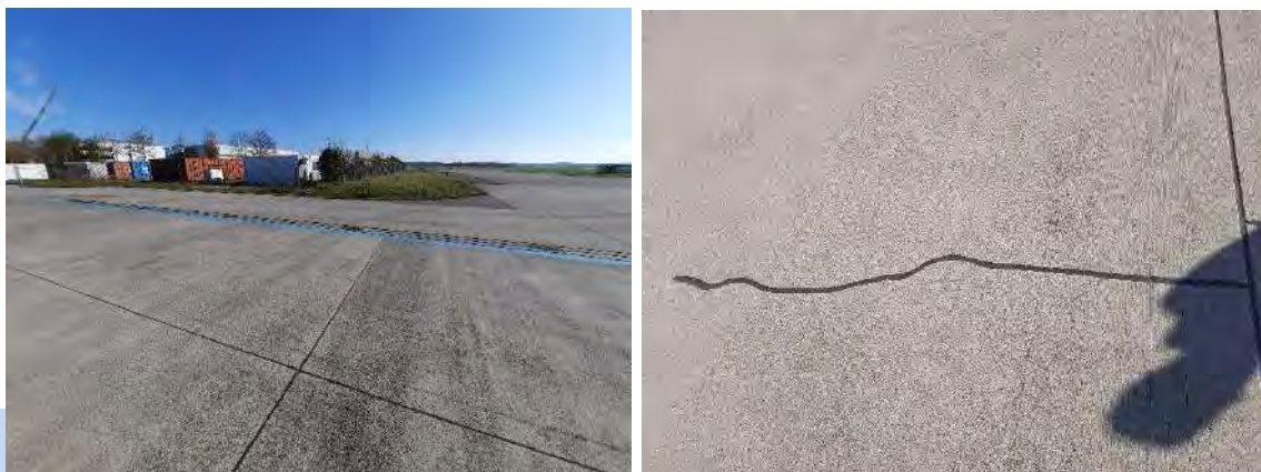
Abbildung 44: Manipulationsfläche vor Gebäude 160. Links: Abflussrinne, rechts: nachgefräster und verkitteter Riss. Foto: HYDRODATA GmbH, 29.10.2024
