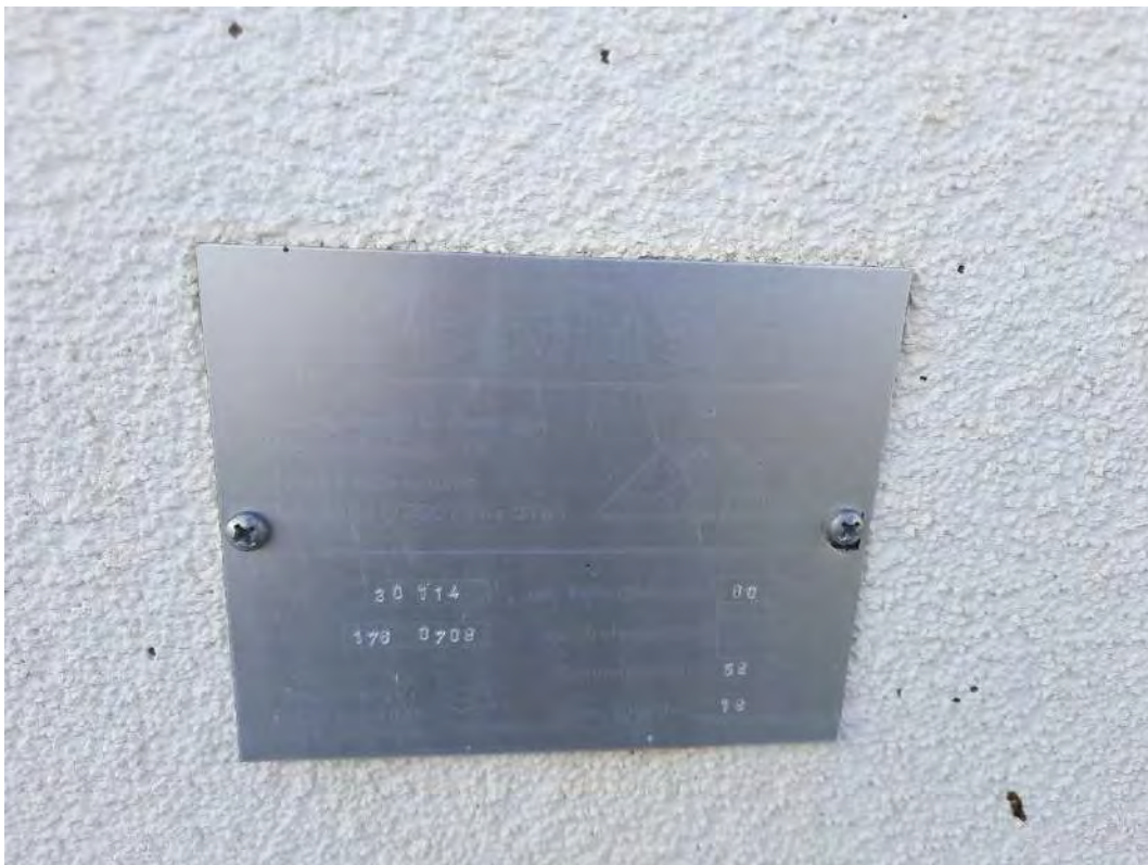
Abb. 50: KVF Nr. 14 – Trafogebäude 151 Typenschild des Trafogebäudes. Foto: Hydrodata GmbH, 29.10.2024
