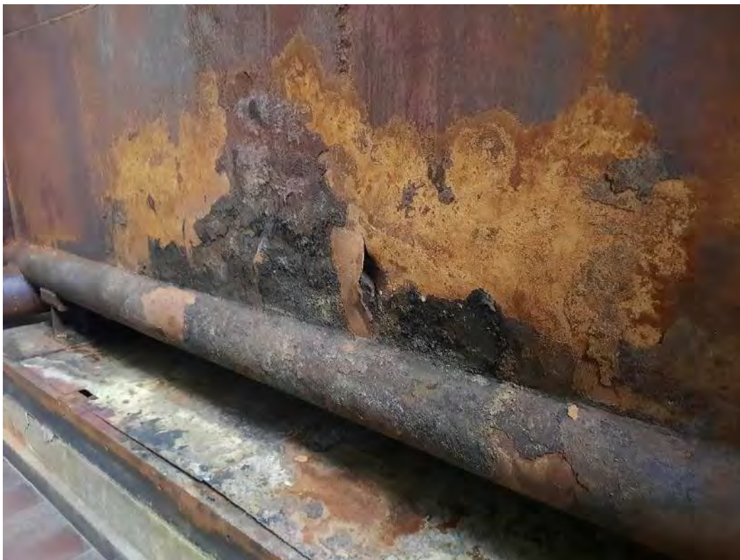
Abb. 24: KVF Nr. 07 – Stillgelegter Heizraum Starke Rosterscheinungen an einem der Kessel Foto: Hydrodata GmbH, 29.10.2024
