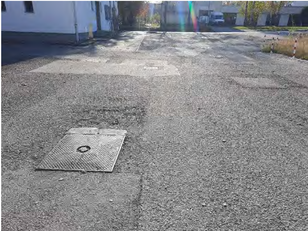
Abb. 9: KVF Nr. 04 – Abgerissene Fahrbereitschaft Der nicht identifizierbare Schachtdeckel. Blick nach Süden. Foto: Hydrodata GmbH, 29.10.2024
