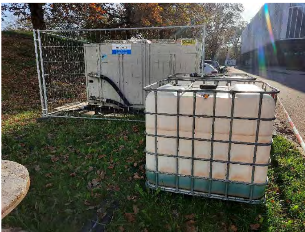
Abb. 79: KVF Nr. 26 – Notkühlung Blick auf das Kühlensembel. Blick Richtung Süden. Foto: Hydrodata GmbH, 29.10.2024
