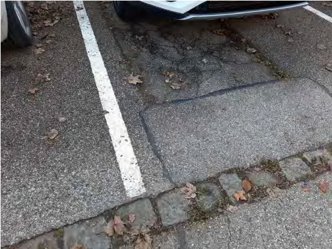
Abb. 75: KVF Nr. 24 – Parkplatz P175 Geflickte Bodenversiegelung auf Parkplatz P175. Foto: Hydrodata GmbH, 29.10.2024
