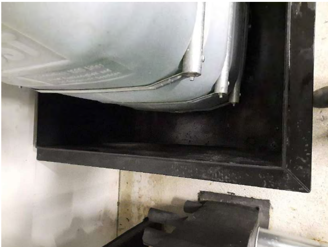
Abb. 16: KVF Nr. 05 – Heizraum Gebäude 109 Blick in die Wanne des Glykoltanks. Foto: Hydrodata GmbH, 29.10.2024
