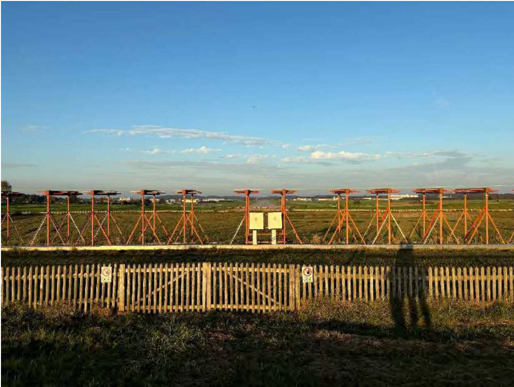
Abb. 100:KVF Nr. 32 – Wiese, Flurstück 828 Die Funkleitfeuerung des Flugplatzes mit Flugplatz im Hintergrund. Blick nach Nordosten. Foto: Hydrodata GmbH, 29.10.2024
