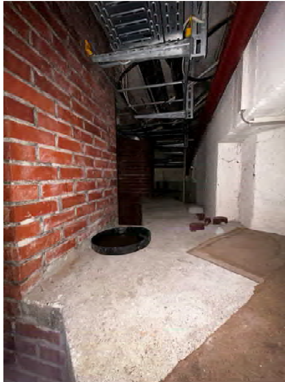
Abb. 27 KVF Nr. 07 – Stillgelegter Heizraum Abluftzuleitungen zum Kamin. Blick nach Südwesten. Foto: Edgar Geyer (DLR), 19.12.2024
