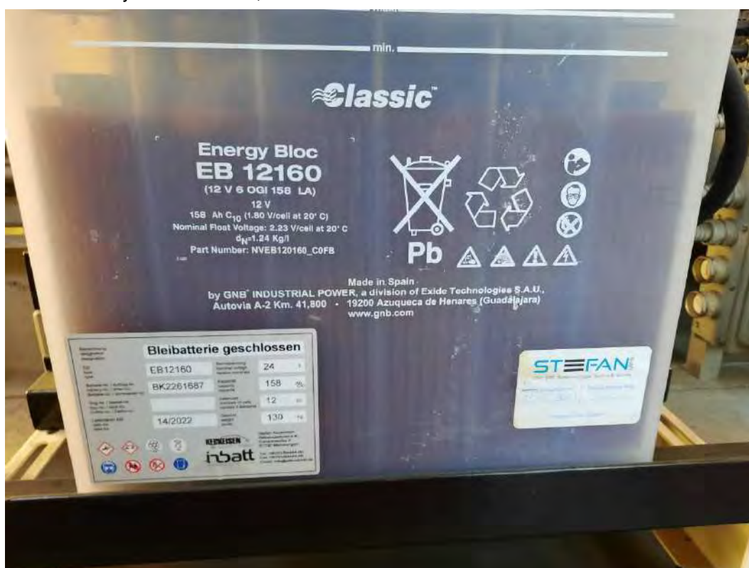
Abb. 35: KVF Nr. 08 – Notstromaggregat Detailaufnahme Typenschild der Batterien. Foto: Hydrodata GmbH, 29.10.2024
