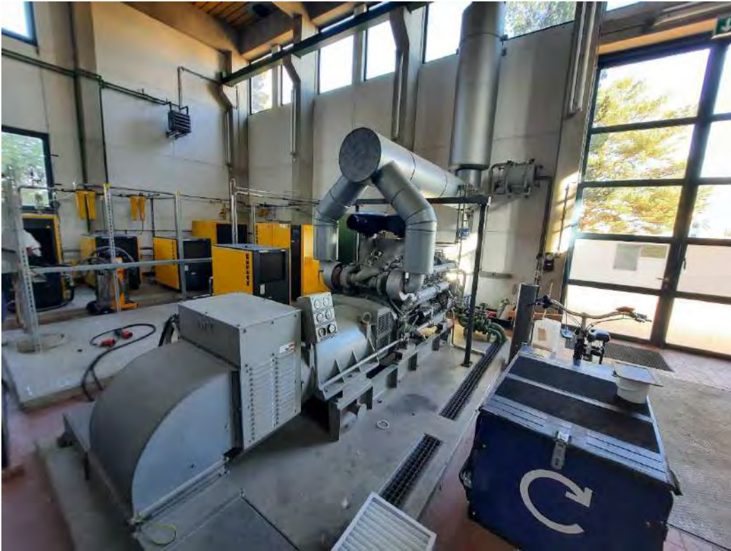
Abb. 30: KVF Nr. 08 – Notstromaggregat Blick nach Norden auf das Notstromaggregat. Links im Hintergrund ist die Druckluftversorgung des Gebäudes zu erkennen. Links vom Eingangstor hängt der Schmieröltank des Aggregats an der Wand. Foto: Hydrodata GmbH, 29.10.2024
