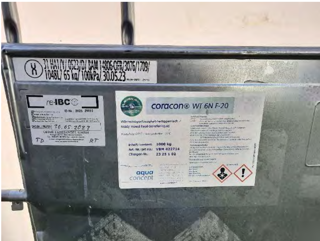
Abb. 84: KVF Nr. 26 – Notkühlung Tankbeschriftung, Foto: Hydrodata GmbH, 29.10.2024
