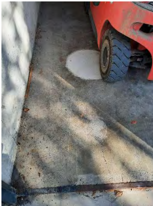
Abbildung 34: Versiegelte Zuflüsse des Abscheiders in Gebäude 113. Foto: HYDRODATA GmbH, 29.10.2024
