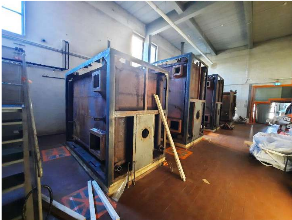
Abbildung 22: Sicht in den Heizungsraum. Foto: HYDRODATA GmbH, 29.10.2024
