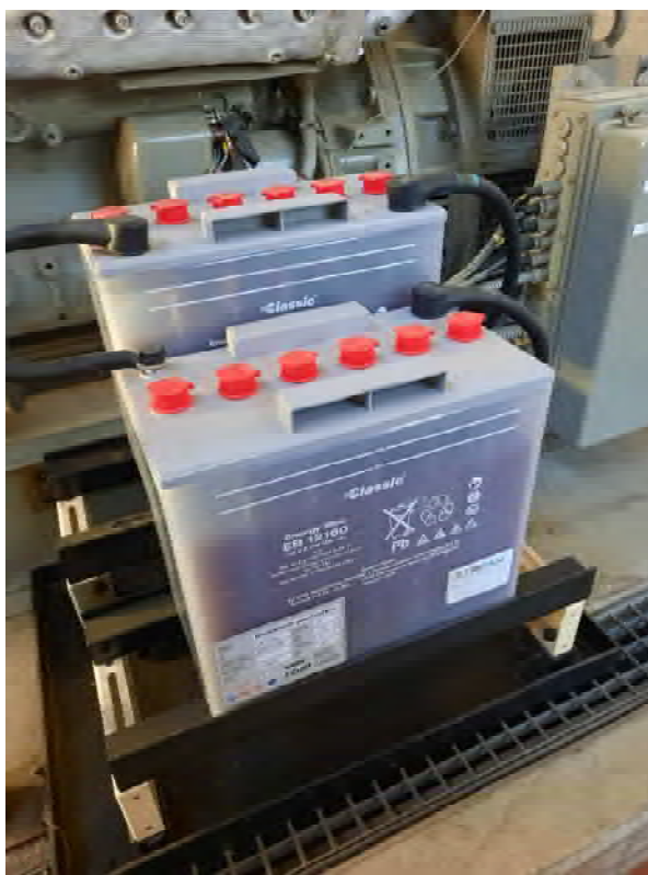
Abb. 34: KVF Nr. 08 – Notstromaggregat Startbatterien des Aggregats mit Auslaufwanne. Foto: Hydrodata GmbH, 29.10.2024
