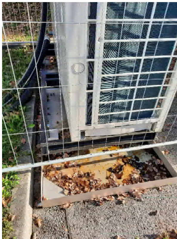
Abb. 82: KVF Nr. 26 – Notkühlung Auffangwanne der Kühleinheit. Bei der Flüssigkeit handelt es sich vermutlich um Kondenswasser. Foto: Hydrodata GmbH, 29.10.2024
