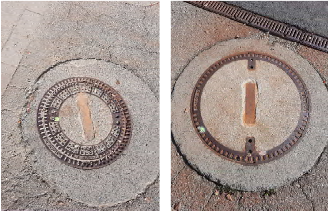
Abb. 7: KVF Nr. 03 – KFZ-Waschplatz mit Ölabscheider Blick auf die Deckel des stillgelegten Ölabscheider. Foto: Hydrodata GmbH, 29.10.2024
