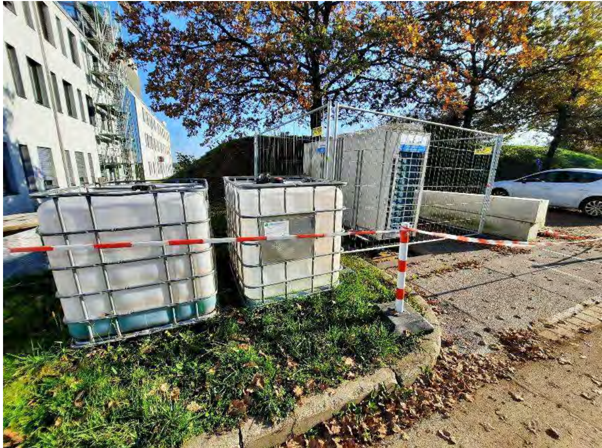
Abbildung 64: Notkühlungs-Anlage für Gebäude 109. Foto: HYDRODATA GmbH, 29.10.2024
