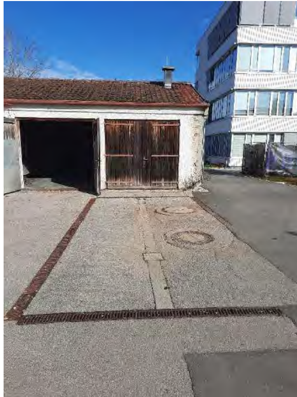
Abbildung 13: Waschplatz mit stillgelegter Abscheideranlage. Foto: HYDRODATA GmbH, 29.10.2024
