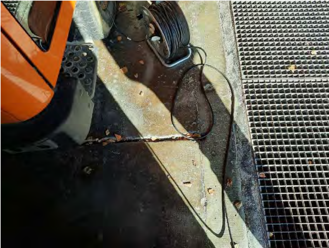
Abb. 5: KVF Nr. 02 – PKW-Garage mit Wartungsgrube Riss in der Bodenversiegelung neben der Wartungsgrube. Foto: Hydrodata GmbH, 29.10.2024
