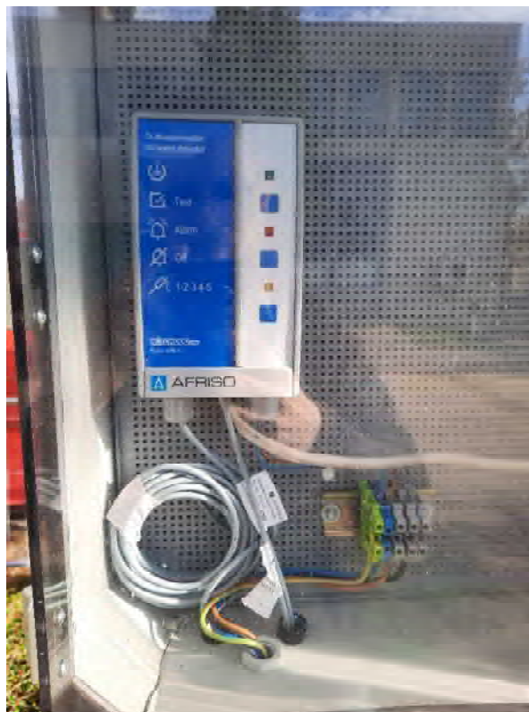
Abb. 37: KVF Nr. 09 – Öltanks Der Öl-Wassermelder der Tanks III-VI. Foto: Hydrodata GmbH, 29.10.2024
