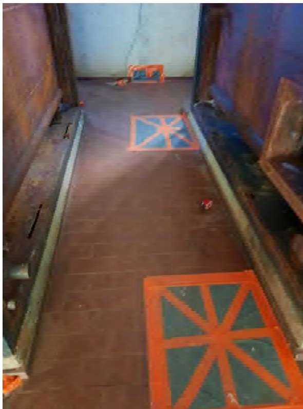
Abb. 23: KVF Nr. 07 – Stillgelegter Heizraum Verschlossene Zu- und Abfuhrschächte zum Keller. Foto: Hydrodata GmbH, 29.10.2024
