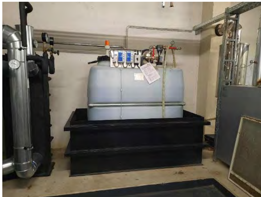
Abbildung 18: Glykoltank in Raum 0001 Gebäude 109. Foto: HYDRODATA GmbH, 29.10.2024
