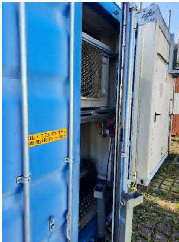
Abb. 63: KVF Nr. 19 – Containerstellfläche Mit Kühleinheit ausgestatteter Container. Foto: Hydrodata GmbH, 29.10.2024
