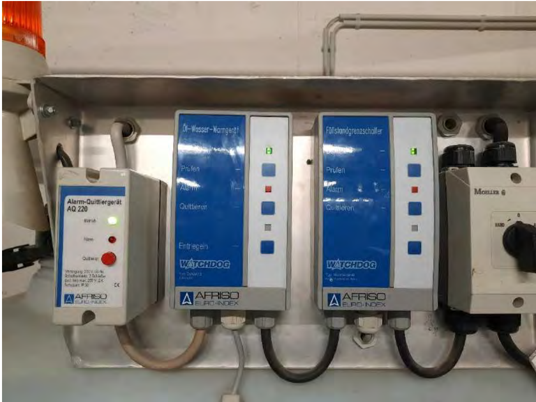
Abb. 15: KVF Nr. 05 – Heizraum Gebäude 109 Detailaufnahme Auslaufwarnsystem. Foto: Hydrodata GmbH, 29.10.2024
