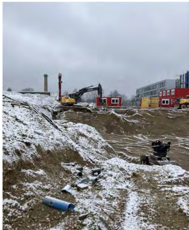
Abb. 69: KVF Nr. 21 – Kraftstoffleitung unter Parkplatz P172 Aktueller Zustand der Baustelle mit ausgerissenen Rohren. Blick nach Westen. Foto: Clemens Rausch (DLR), 18.02.2025
