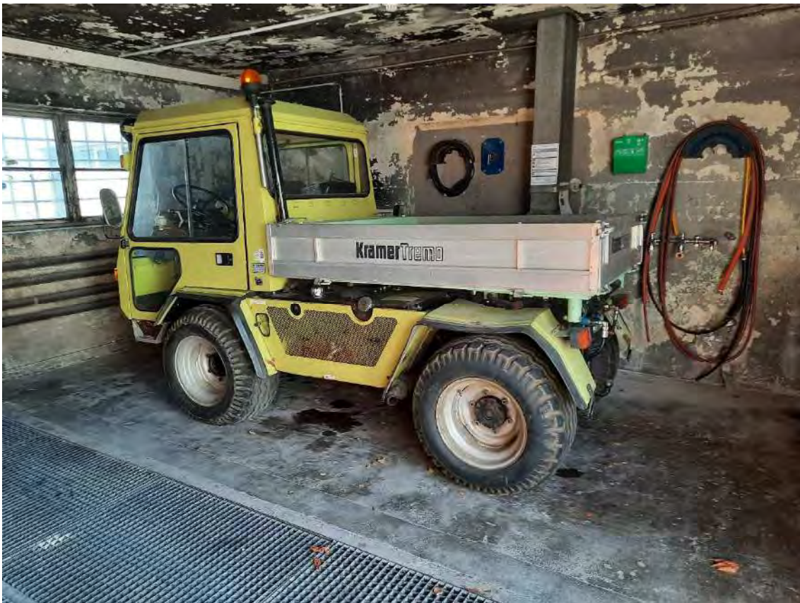
Abb. 4: KVF Nr. 02 – PKW-Garage mit Wartungsgrube Blick auf die Osthälfte der Garage mit geparktem Fahrzeug. Foto: Hydrodata GmbH, 29.10.2024
