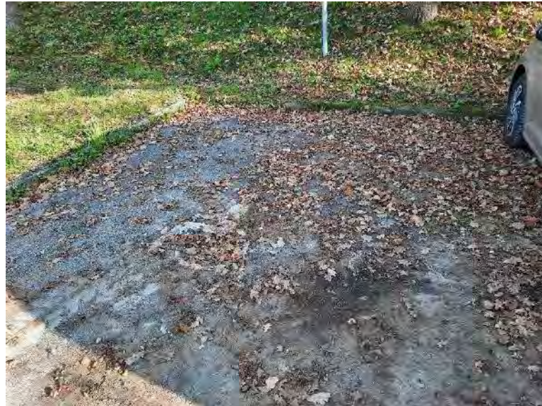
Abbildung 62: Vermutete Ölverunreinigung im Bereich des Parkplatzes P176. Foto: HYDRODATA GmbH, 29.10.2024
