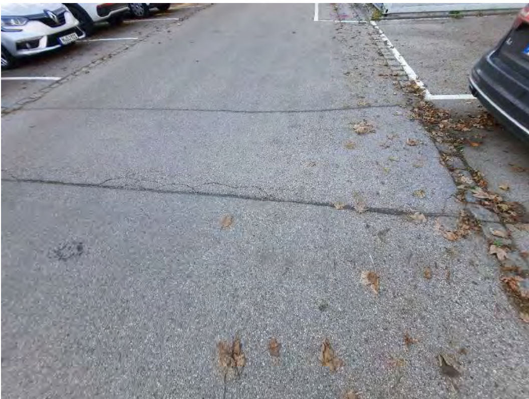
Abb. 76: KVF Nr. 24 – Parkplatz P175 Risse in der Bodenversiegelung auf Parkplatz P175. Foto: Hydrodata GmbH, 29.10.2024
