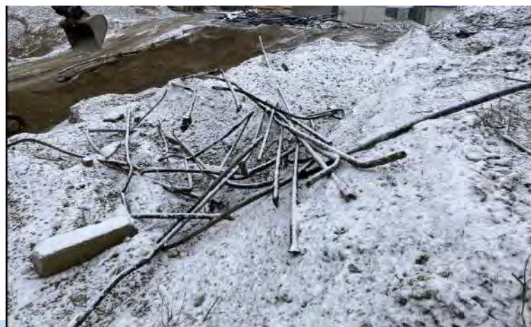
Abbildung 54: Ausgebaggerte Kraftstoffleitungen unter Parkplatz P172. Foto: Clemens Rausch (DLR), 18.02.2025
