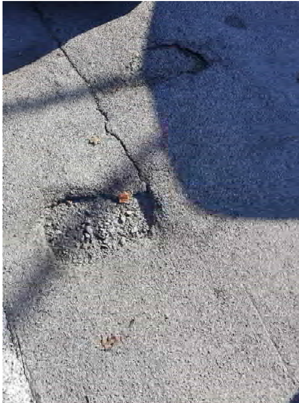
Abb. 72: KVF Nr. 22 – Parkplatz P174 Schlaglöcher in der Asphaltdecke. Foto: Hydrodata GmbH, 29.10.2024
