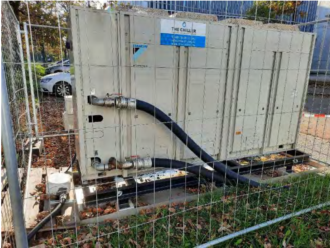
Abb. 81: KVF Nr. 26 – Notkühlung Die Kühleinheit mit untergestellter Auffangwanne. Blick nach Süden. Foto: Hydrodata GmbH, 29.10.2024
