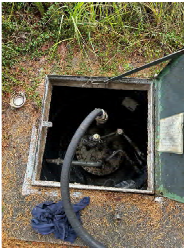
Abb. 39: KVF Nr. 09 – Öltanks Tank III mit geöffneter Abdeckung. Foto: Hydrodata GmbH, 30.10.2024
