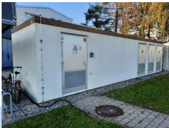
Abbildung 40: Außenansicht Trafo 151. Foto: HYDRODATA GmbH, 29.10.2024
