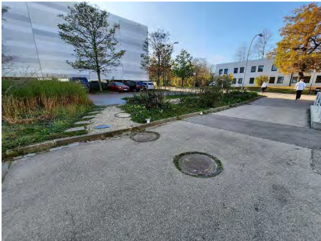
Abbildung 5: Abdeckungen des alten Fettabscheiders. Foto: HYDRODATA GmbH, 29.10.2024
