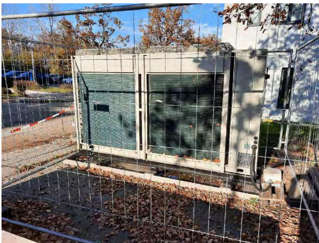
Abb. 80: KVF Nr. 26 – Notkühlung Die Kühleinheit mit untergestellter Auffangwanne. Blick nach Norden. Foto: Hydrodata GmbH, 29.10.2024
