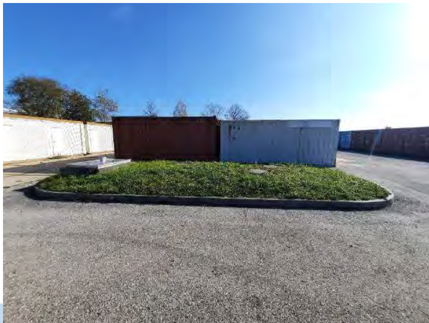
Abbildung 47: Zugangsöffnungen der Abscheideranlage. Rechts: Abscheider, Mitte: Probenahmeschacht, Links: Hebeanlage. Foto: HYDRODATA GmbH, 29.10.2024
