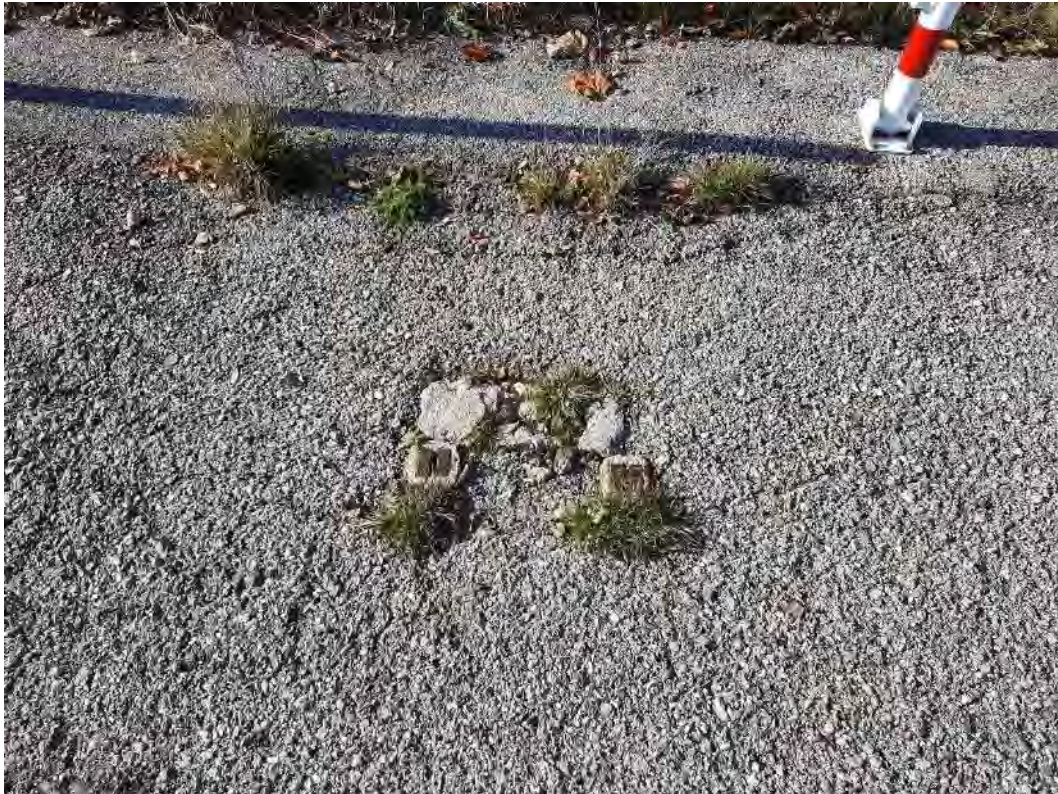
Abb. 11: KVF Nr. 04 – Abgerissene Fahrbereitschaft Blick auf einen übriggebliebenen Betonsockel der abgerissenen Fahrbereitschaft. Foto: Hydrodata GmbH, 29.10.2024
