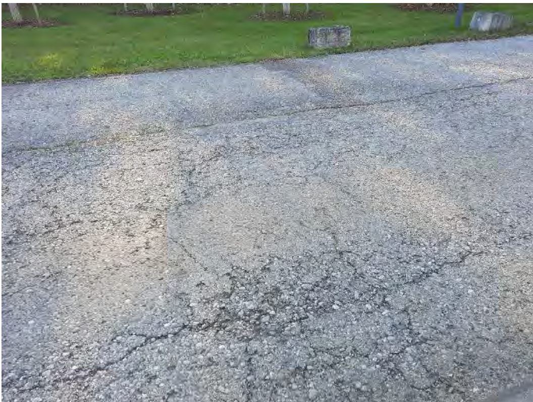
Abb. 89: KVF Nr. 28 – Parkplatz P179 Rissige Bodenversiegelung im Bereich des Parkplatzes. Foto: Hydrodata GmbH, 29.10.2024
