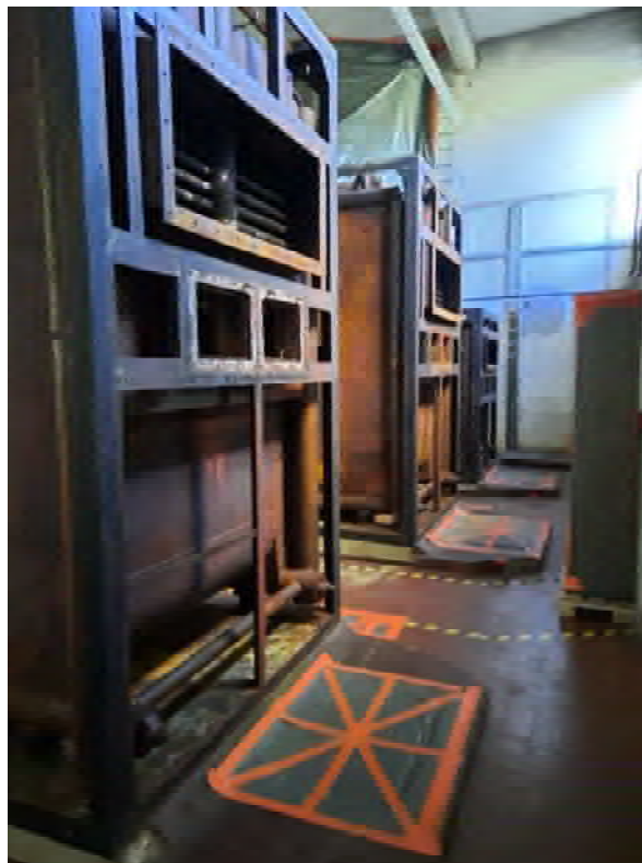
Abb. 21: KVF Nr. 07 – Stillgelegter Heizraum Rückseite der stillgelegten Heizkessel. Unter den abgeklebten Schächten ist die Verbindung zum Schornstein durch den Keller. Blick nach Süden. Foto: Hydrodata GmbH, 29.10.2024
