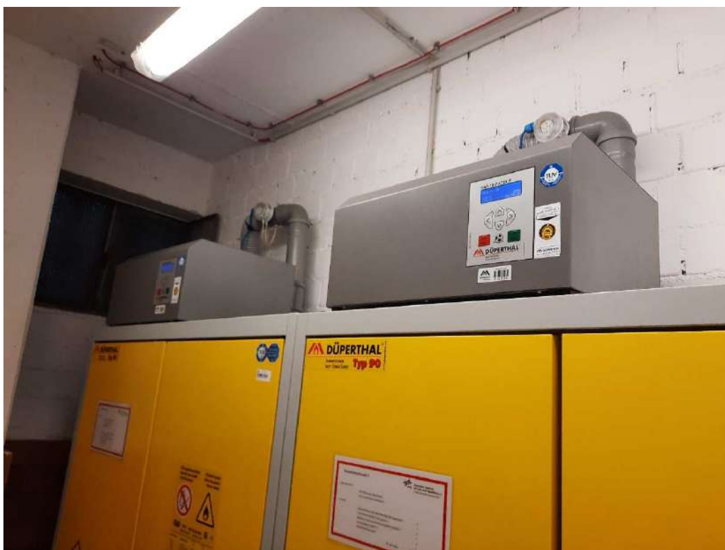
Abb. 45: KVF Nr. 13 – Schadstofflager Gebäude 113 Abluftsystem der Sicherheitsschränke. Foto: Hydrodata GmbH, 29.10.2024
