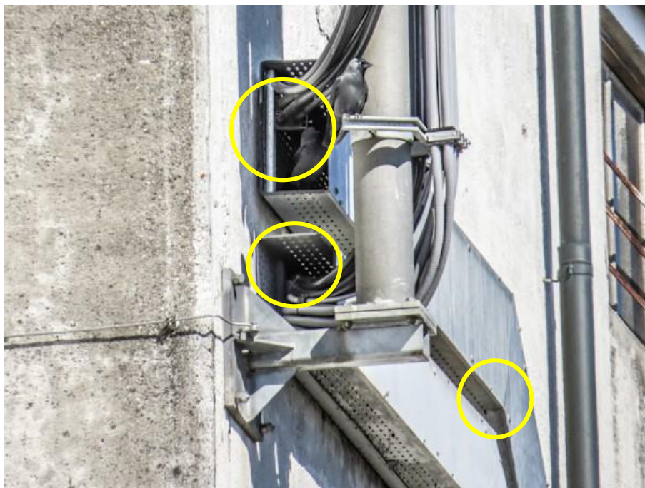
Abb. 3: Drei Brutplätze der Dohlen in Hohlräumen des Antennenaufbaus
